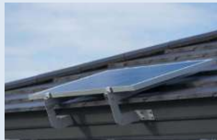
ระบบพัดลมและช่องระบายอากาศใต้หลังคา (Solar Attic)
