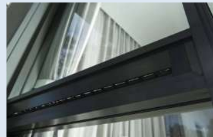
ช่องระบายลมในตัวบ้าน (Breeze Panel)
