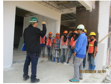
การควบคุมงานที่มีความเสี่ยง เช่น งานบนที่สูง
